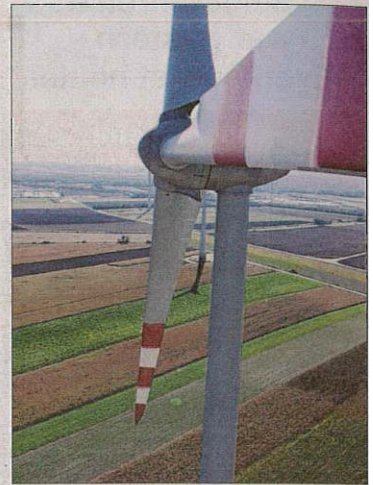
Das 72. und damit letzte Rotorblatt der 24 Anlagen wurde installiert. Fotos: Energiepark Bruck
