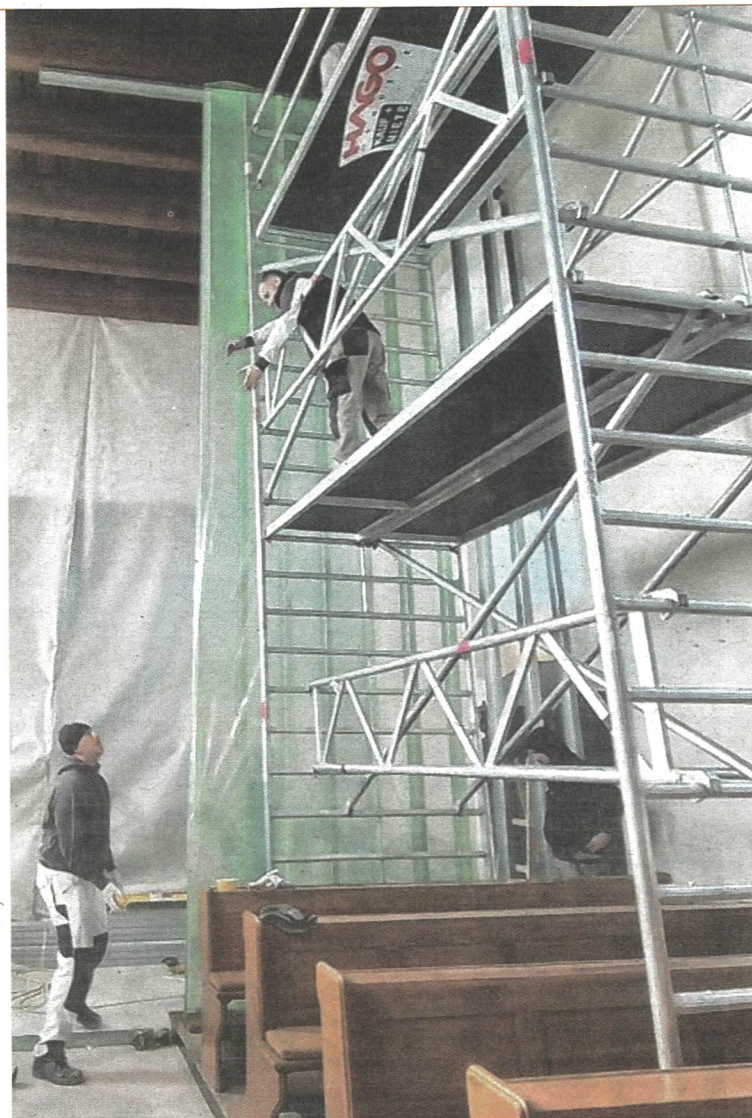
▲ Die Baumaßnahmen für die neue Orgel haben diese Woche begonnen. Foto: Adam Konopka
