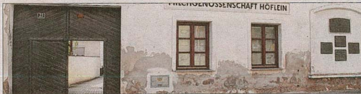
Bis in einen Meter Höhe dringt die Feuchtigkeit an der Außenmauer.
