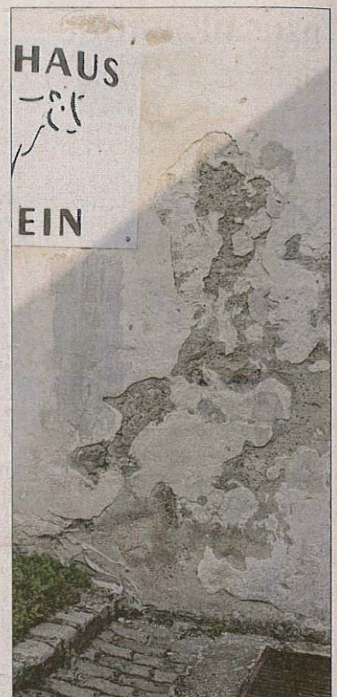
Auch im Innenbereich und im Hof ist das Gemäuer des Milchhauses Höflein sehr feucht. Fotos: Kirchhauer
